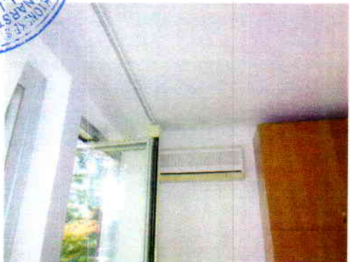
Upravna zgrada - klima-uredjaj u kancelariji u prizemlju
